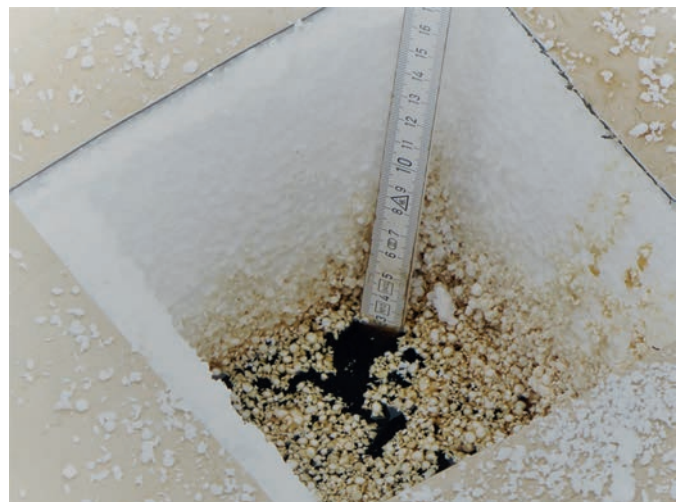
Bild 4. Dachöffnung – stehendes Wasser im Dämmpaket (Foto: Kuno Haedler, Sachverständiger)
