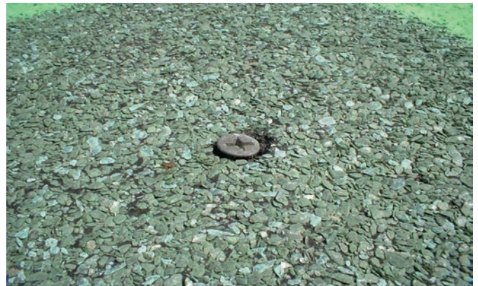
Bild 3. Perforation der Abdichtung
